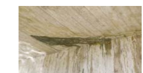
築50年経過後のRC部材の変状
